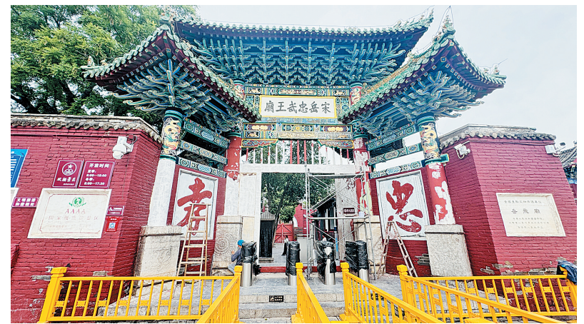
工人正在对汤阴县岳飞纪念馆外墙进行粉刷翻新(本报记者 李雪 摄)
