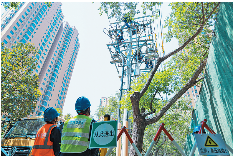
4月30日,国网安阳供电公司在灯塔路与光明路交叉口采用不停电作业方式,完成10千伏灯塔东线1号开关更换,以提升线路夏季供电可靠性。(本报记者 邓娟 摄)
