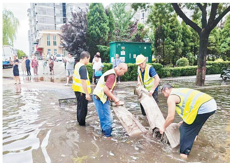
市政维护人员在清理道路积水(市政维护发展中心供图)
