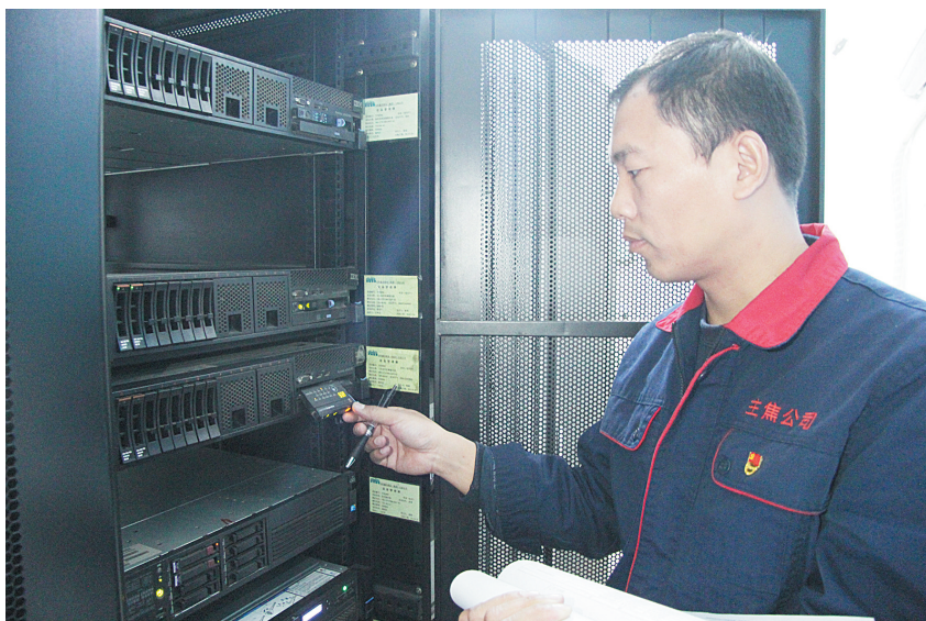
展阔在巡检数据中心的服务器
