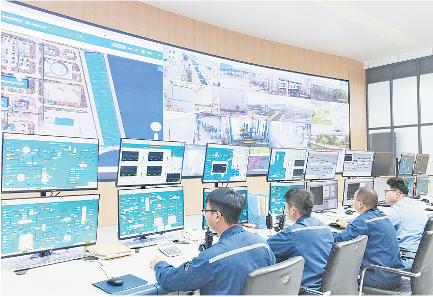
工人在智能集控中心操控生产
