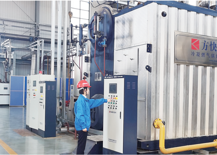
卢洁正在调试锅炉参数
