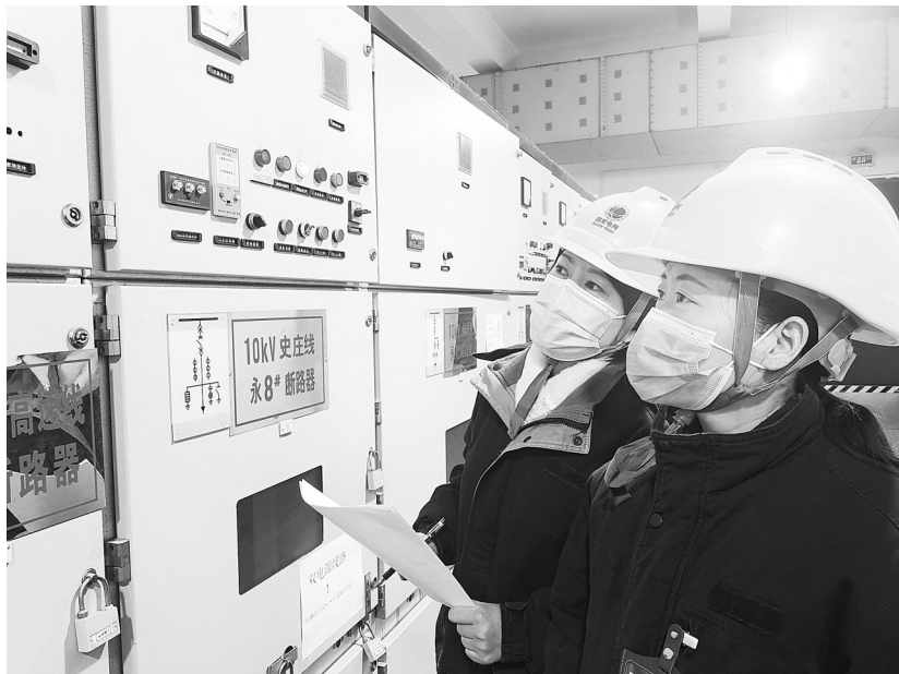
国网安阳供电公司工作人员在变电站内进行设备巡视(姚合喜 摄)
