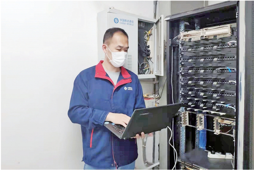
史路正在机房进行基站扩容调试(靳乐 摄)
