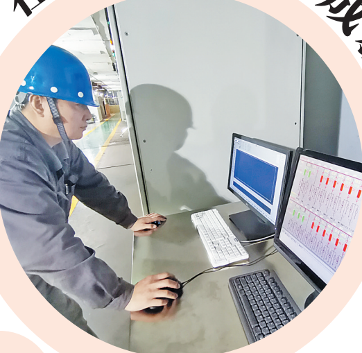
翁蕴智正在观察17号主电机运行情况
