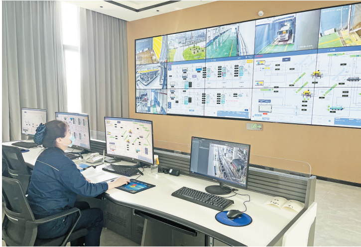
工作人员在中央控制室内作业
