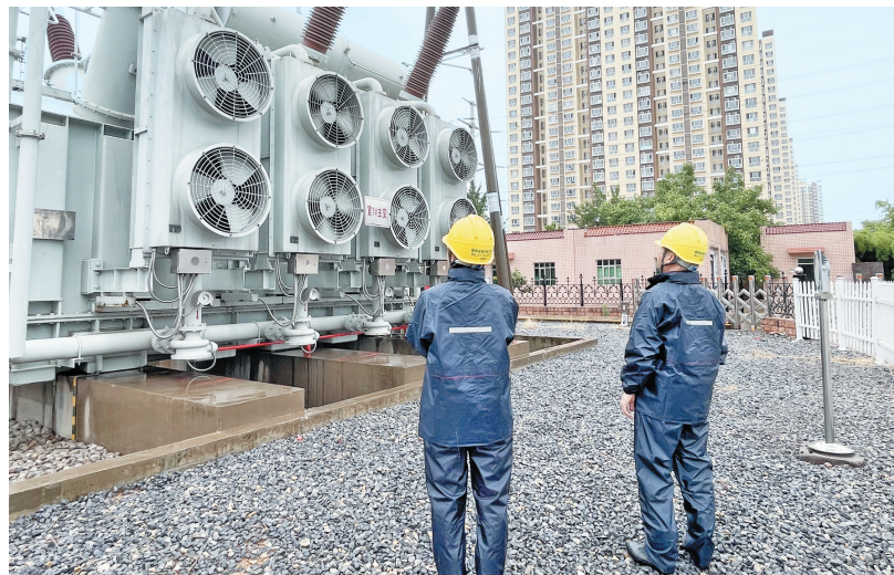
国网安阳供电公司运维人员对220千伏官庄变电站1号主变进行巡视（莫亚丽 摄）
