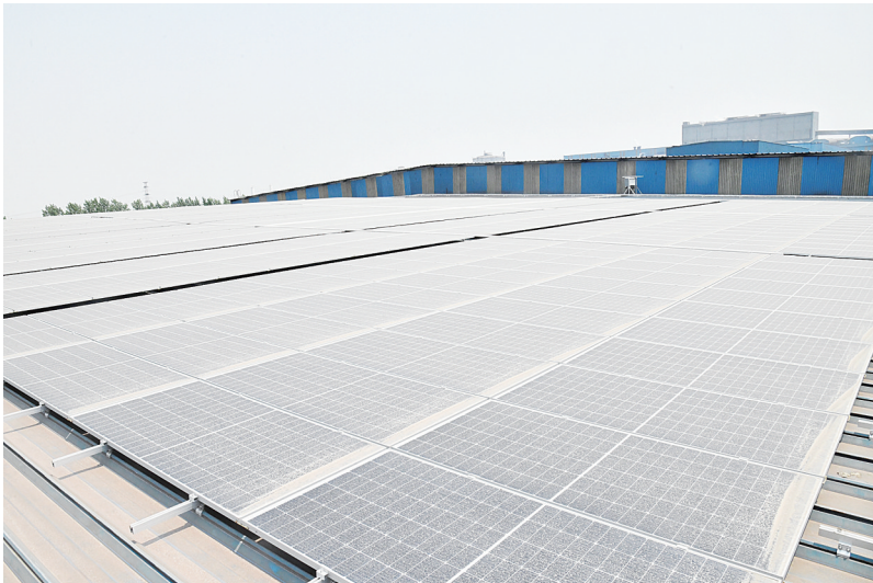
该公司5.9MW分布式光伏发电项目现场
