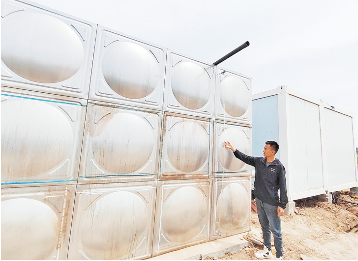
毫城镇智慧辣椒产业基地建设项目负责人曹玉龙介绍蓄水池和水肥一体化管理房
