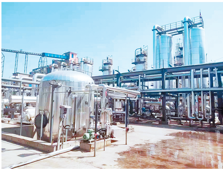
顺利甲醇联产LNG项目现场(王存兵 摄)
