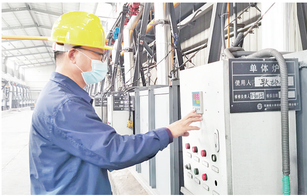
工人在车间操作设备
