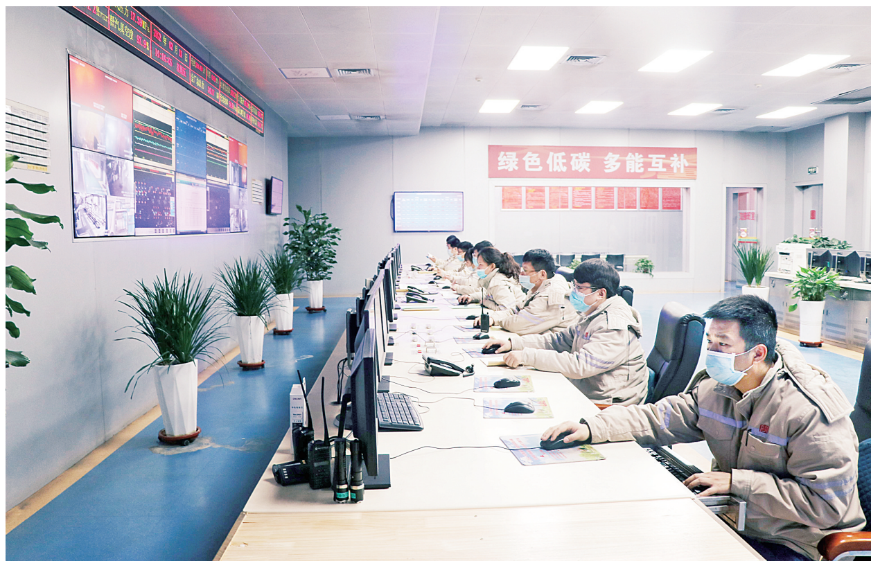
大唐林州热电的集控室人员在认真监控生产线
