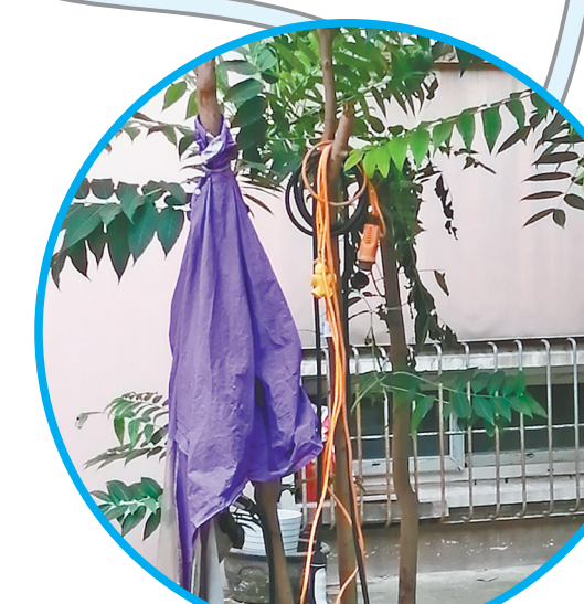
充电电线随意挂在树上,存在安全隐患 (本报记者 高咪 摄)
