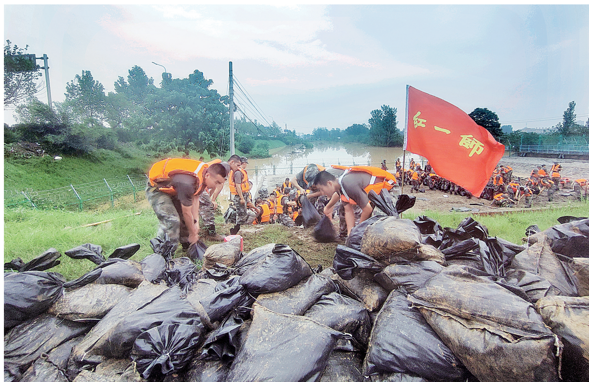
7月22日,南水北调河南汤阴段突发管涌险情,陆军第83集团军某旅组织官兵利用沙袋加固大堤。新华社发(郭炳乾 摄)
