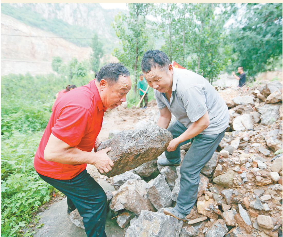
7月18日下午,位于殷都区都里镇漳河南岸的许家滩村,在村党支部书记郭虎林的带领下,村干部抢修被大水冲毁的堤坝。(毕兴世 摄)
