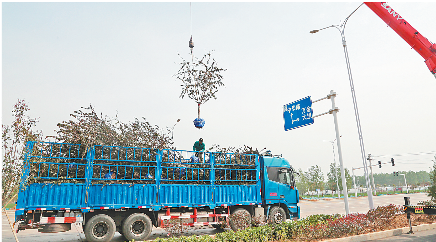
当下,北关区正以时不我待、只争朝夕的精神,全力全速高质量推进重点项目建设。图为4月15日,万金大道两侧绿化项目现场。(杨光明 摄)
