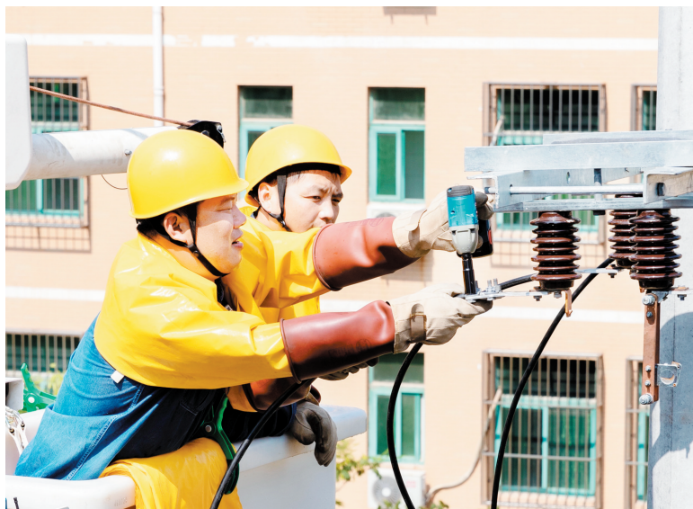
国网滑县供电公司工作人员正在进行带电作业(王亚方 摄)
