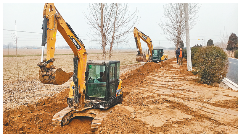
内黄县扎实推进“四好农村路”创建工作常态化、制度化、规范化、精细化,巩固创建工作成果,提升管理养护成效,打造“畅、洁、绿、美、安、舒”的农村公路交通环境。各乡镇及交通部门打好“四好农村路”创建攻坚战,路路通车、行道绿化、环线打造、路域环境治理全面铺开,形成了全域创建、大干快上、比学赶超、奋力冲刺的良好局面,创建工作氛围空前浓厚,阶段性工作取得显著成效。图为1月5日该县“四好农村路”建设现场。(黄洪坡 摄)
