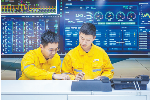
值班人员对风机运行数据进行分析
