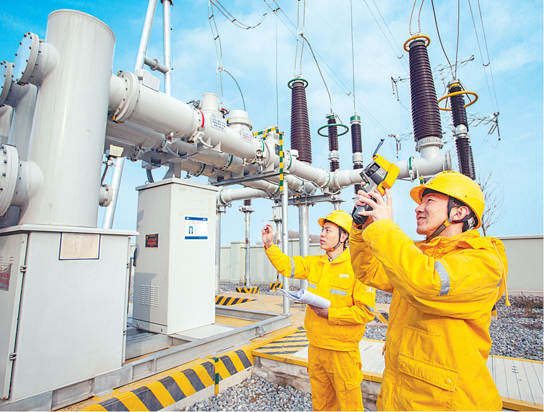
工作人员对设备、线路温控例行检测
