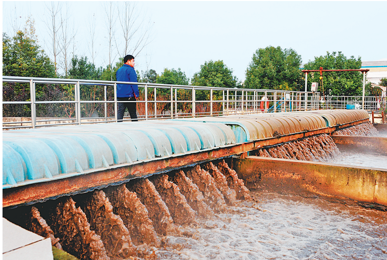
在河南省南阳市淅川县污水处理厂，工作人员在巡察设备运转状况(2015年11月27日摄)。(新华社记者 冯大鹏 摄)
