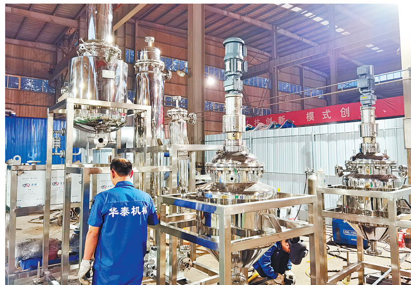
河南华泰粮油机械股份有限公司生产车间(闫子鹏 摄)
