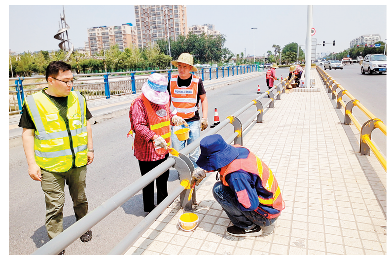
彰德路洪河桥隔离栏杆锈蚀严重,为了确保车辆通行安全,提升城市市政设施整体形象,市市政维护发展中心对该桥分车带隔离栏杆560米进行更新改造。
