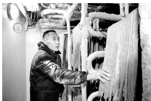
韩增茂在冷库内检查冷冻情况
