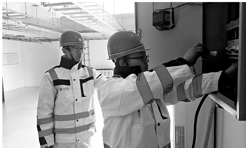
移动网络施工人员将发电机的电源线接到机房(王金星 摄)
