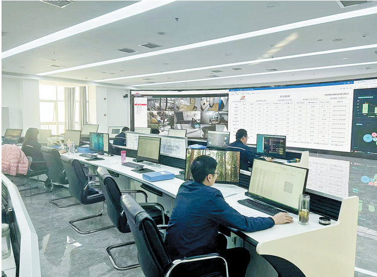
益和热力工作人员对供热参数进行调度
